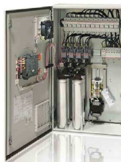
Intérieur de la Q100 (exemple : 120 kvar à 600 V)
